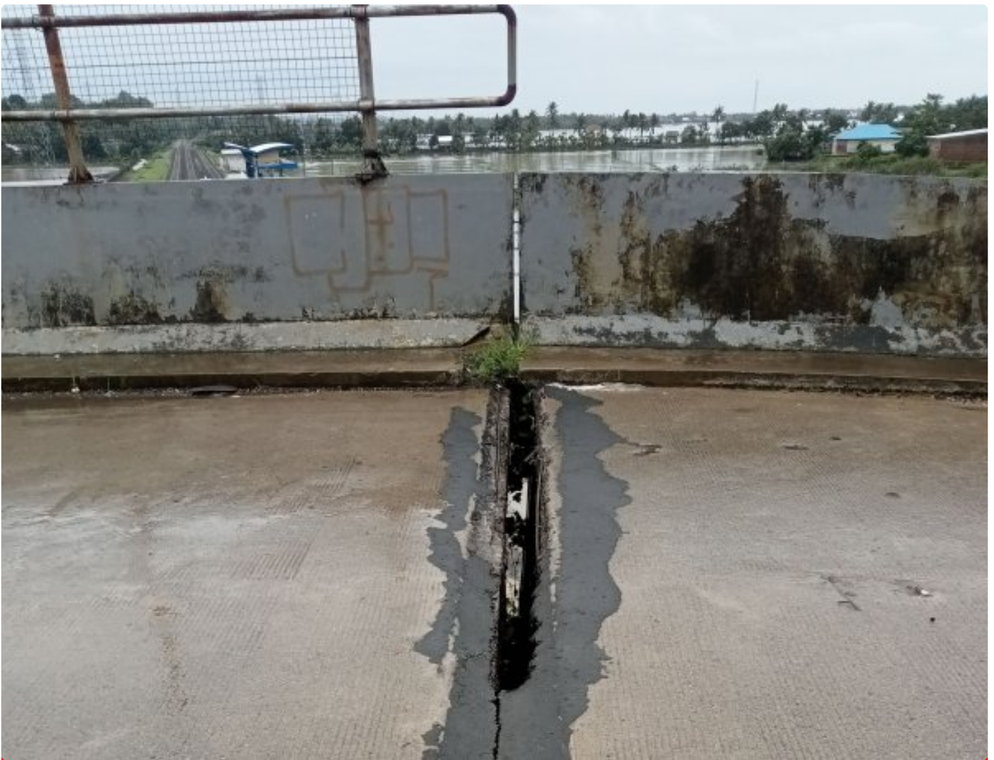
Sambungan jalan fly over Pekkae rusak parah
